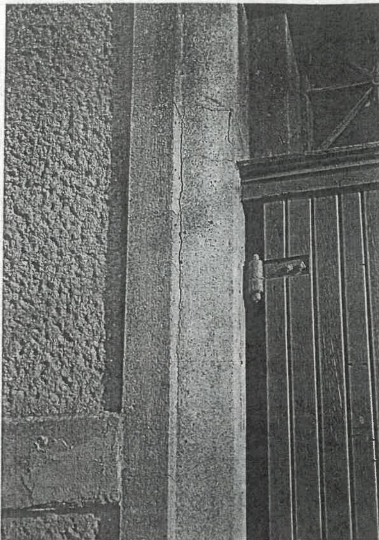
Zdjęcie nr 3 – Wieża, drzwi wejściowe do kościoła. Na zdjęciu widoczne uszkodzenia tynku wzdłuż pionowych ościeży drzwi wejściowych do kościoła.
