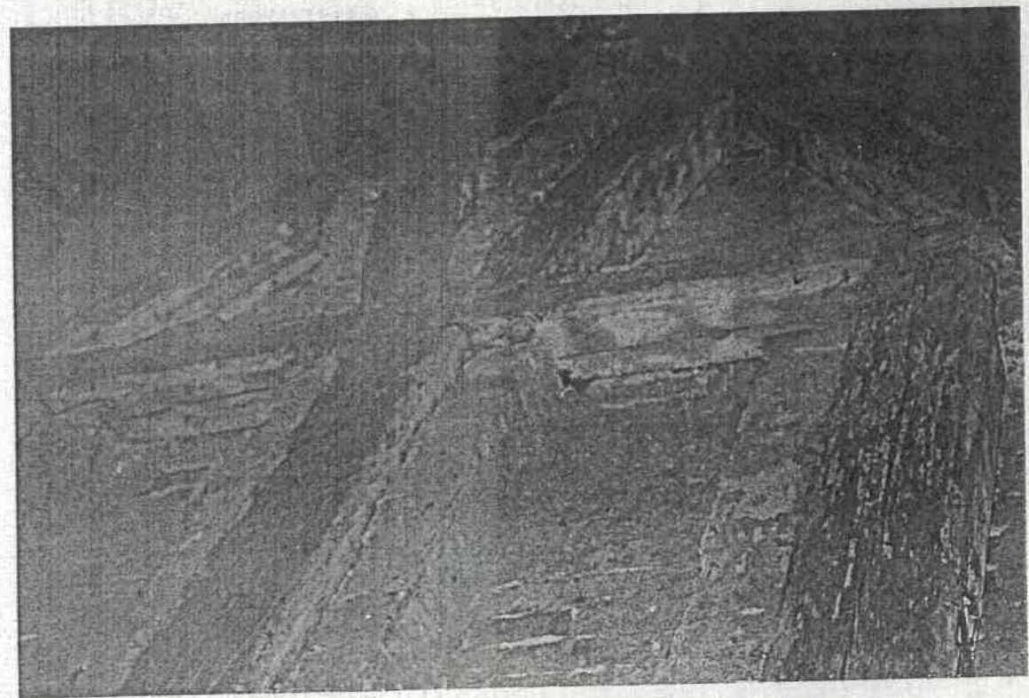
Zdjęcie nr 18 – Ściana szczytowa wschodnia w poziomie strychu. Na zdjęciu widok więźby dachowej i belkowania ściany od wewnątrz. Wszystkie elementy drewniane porażone przez grzyby i owady. Zniszczone powierzchniowo do głębokości 3,0cm oraz gniazdowo ubytki przekroju do 60% przy szczycie więźby i w okolicach oparcia na murłatach.
