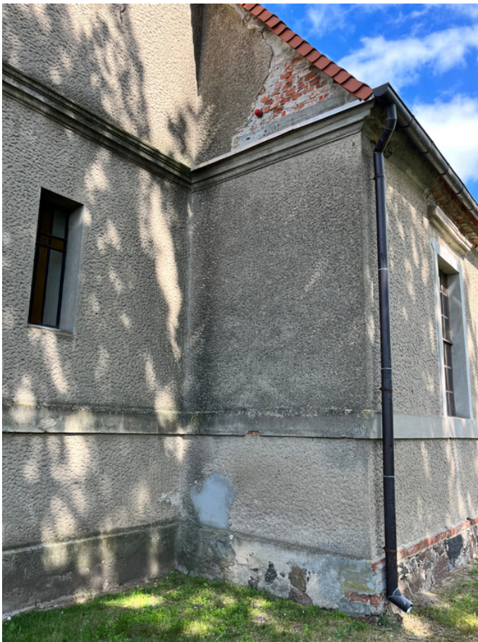
Fot. 11. Południowo-zachodni narożnik na styku korpusu kościoła z wieżą, aktualny stan zachowania. Widoczne wtórne cementowe wyprawy tynkarskie w obrębie lica elewacji, ubytki tynku w części szczytowej oraz liczne kolonie
