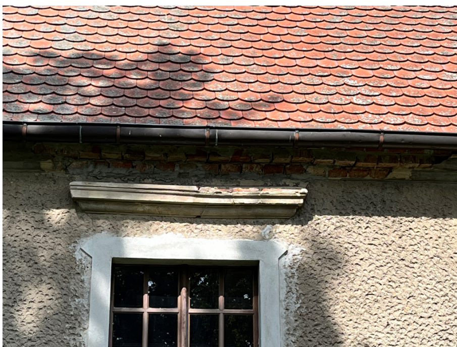
Fot. 9. Fragment elewacji południowej, aktualny stan zachowania. Widoczne zniszczenia wypraw tynkarskich w obrębie gzymsu koronującego oraz naczółka, wtórne przemalowanie powierzchni opaski otworu okiennego oraz otynkowanie lica elewacji szczelnym, rapowanym tynkiem cementowym, z pominięciem historycznej oprawy (boniowanie)
