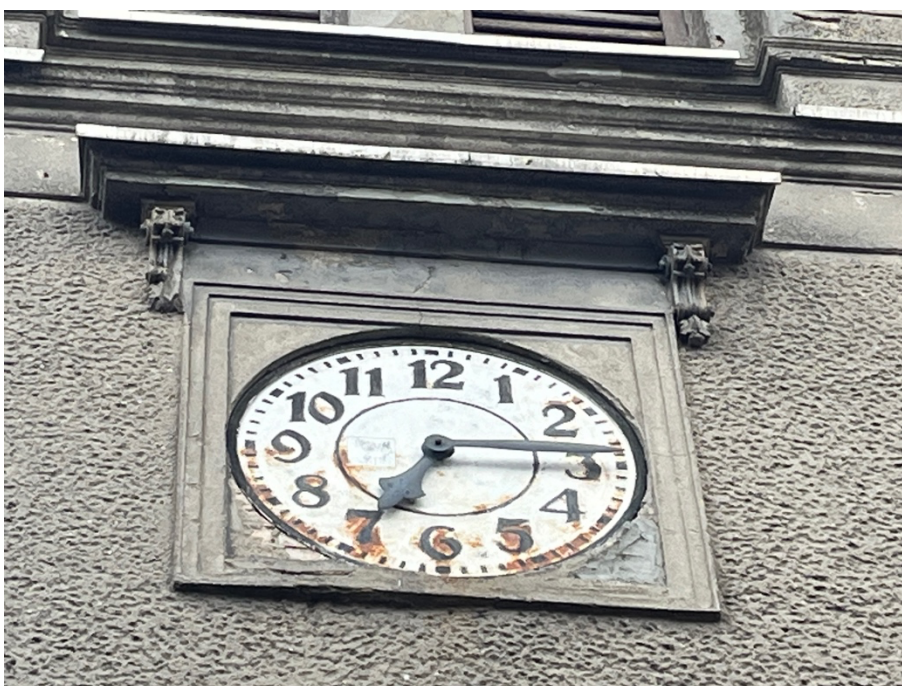
Fot. 17. Tarcza zegarowa w obrębie południowej elewacji wieży, aktualny stan zachowania. Widoczne zniszczenia kwatery w którą wkomponowana jest tarcza oraz liczne produkty korozji pokrywające powierzchnię tarczy.
