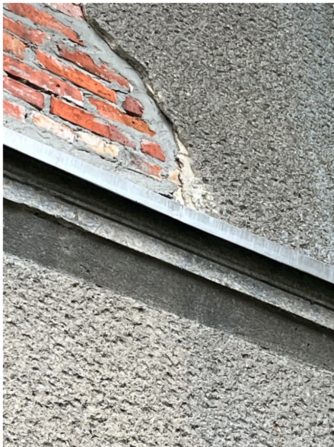
Fot. 15. Fragment elewacji wież z widocznym ubytkiem wyprawy tynkarskiej. W obrębie przełamu pod warstwą wtórnego tynku cementowego widoczne ślady pierwotnego tynku ze śladami boniowania.
