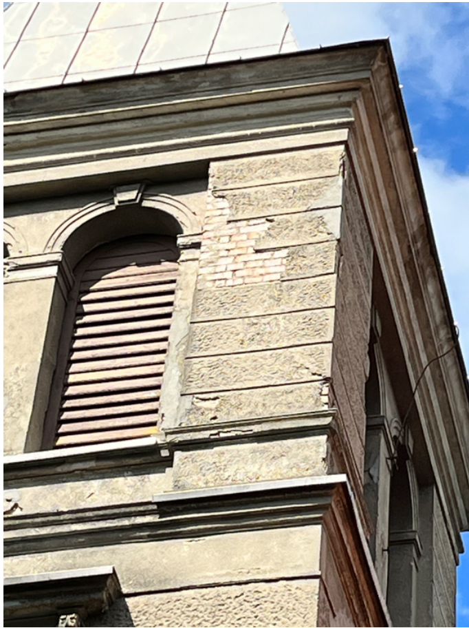
Fot.14. Górne partie wieży w obrębie otworów akustycznych, aktualny stan zachowania. Widoczne m.in. zachowane ślady pierwotnej oprawy tynkarskiej elewacji.
