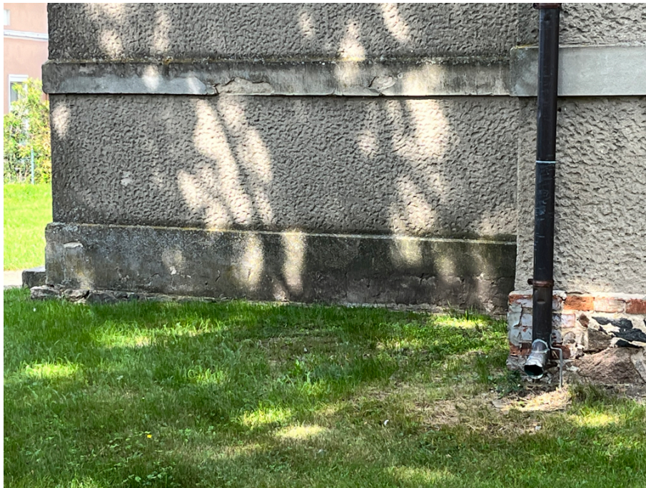
Fot. 13. Dolne partie elewacji południowej wieży, aktualny stan zachowania. Widoczne m.in. ubytki powierzchni w obrębie poziomej opaski, wtórne wyprawy tynkarskie w obrębie lica elewacji oraz intensywny rozwój kolonii mikroorganizmów powierzchni intensywnie i długotrwanie obmywanych wodą.
