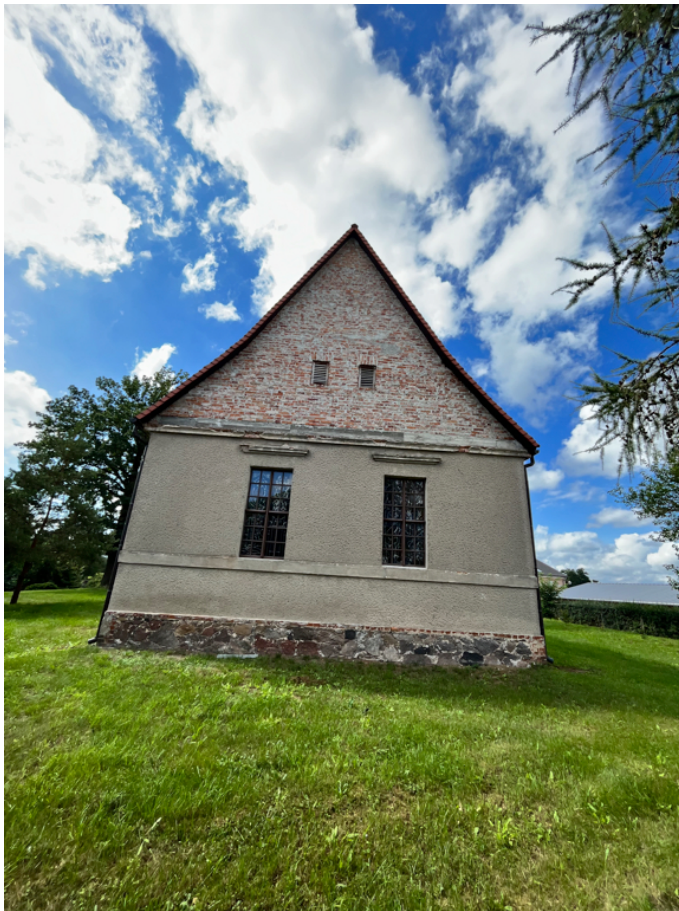
Fot. 6. Elewacja wschodnia, aktualny stan zachowania. Widoczny ubytek tynku w obrębie szczytu i cokołu elewacji, zniszczenia powierzchni profilowanego gzymsu, brak pierwotnych opasek otworów okiennych oraz wtórne otynkowanie powierzchni elewacji szczelnym tynkiem na bazie spoiwa cementowego.
