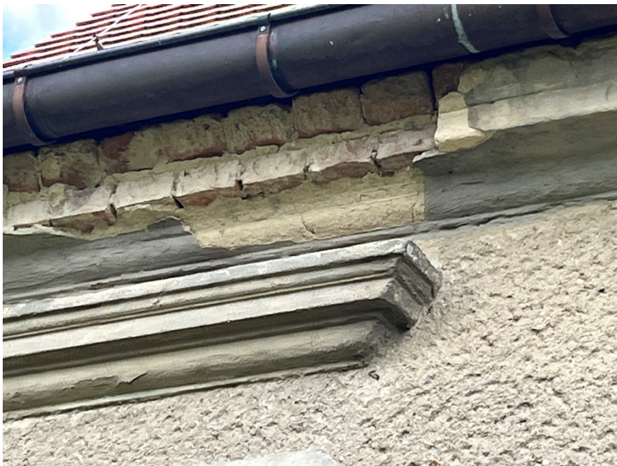
Fot. 7. Fragment gzymsu koronującego w obrębie elewacji północnej, aktualny stan zachowania. Widoczny ubytek profilu gzymsu, wtórne warstwy cementowej szlichty obecne na zachowanej partii gzymsu i naczółku. W obrębie płaszczyzny elewacji widoczny wtórny, rapowany tynk cementowy.
