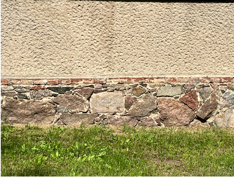
Fot. 10. Dolne partie elewacji południowej, aktualny stan zachowania. Widoczny współczesny rapowany tynk na bazie szczelnego spoiwa cementowego w obrębie lica elewacji oraz wtórne odstąpięty kamienny cokół.
