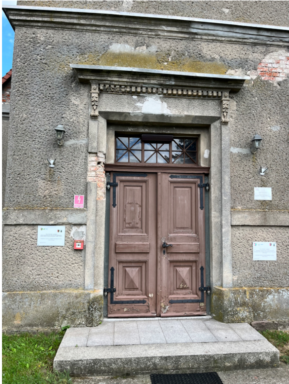
Fot. 4. Główne wejście do kościoła, aktualny stan zachowania. Widoczne ubytki detalu w obrębie portalu oraz profili gzymsu międzykondygnacyjnego; wtórne wyprawy cementowe pokrywające powierzchnie elewacji; ubytki tynku; intensywny rozwój kolonii mikroorganizm.
