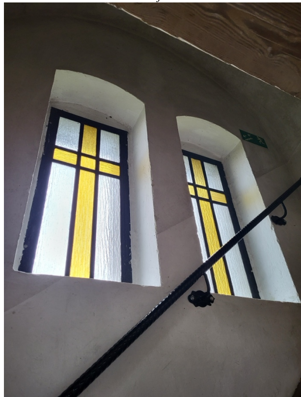
Fot. 17. Wtórna stolarka okienna wieży, aktualny stan zachowania.
