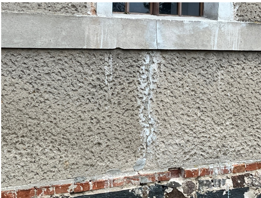
Fot. 16. Fragment elewacji południowej, aktualny stan zachowania. Widoczne strukturalne pęknięcie muru przebiegające przez całą jego wysokość.
